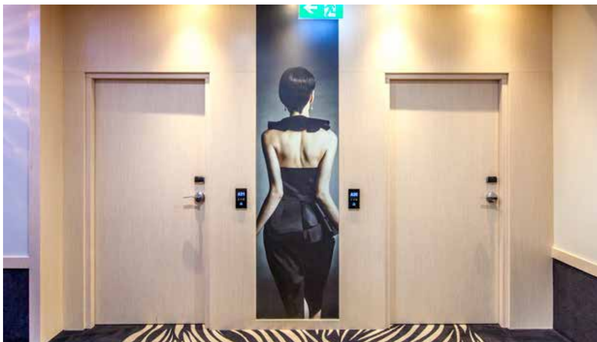
FR EI30 SR fire door, fixed wooden door frame
